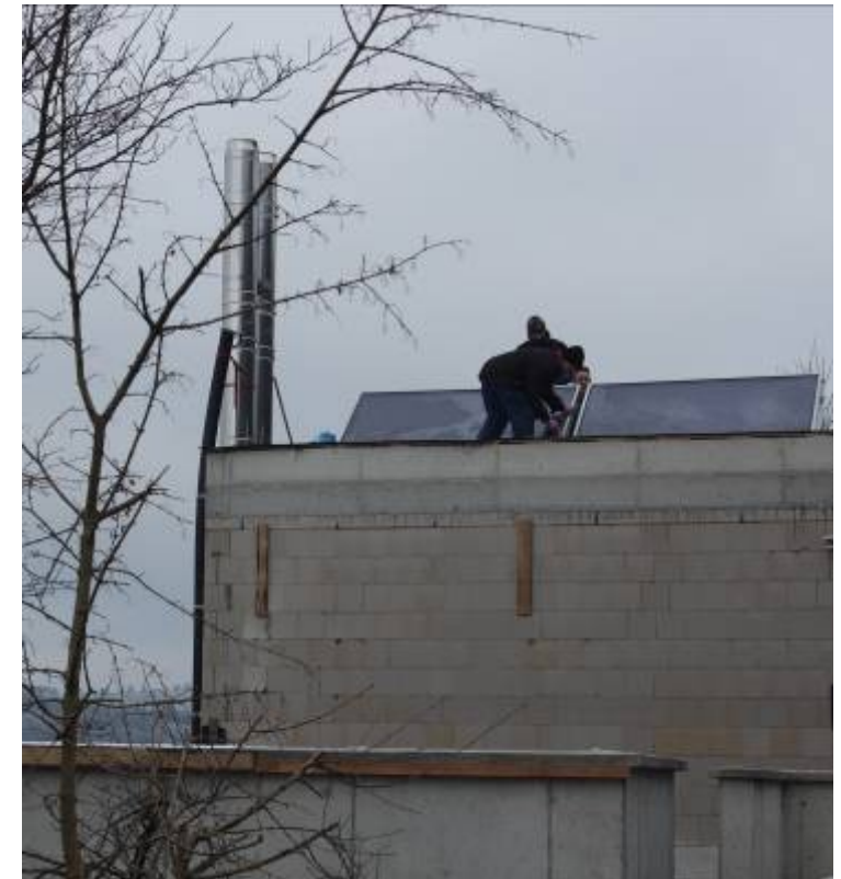
Standort Heizzentrale mit Hackschnitzelsilo u. Solaranlage
