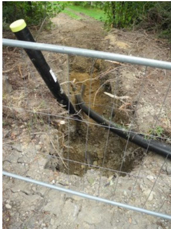
Eine Leitung des Nahwärmenetzes (insgesamt 320 m Leitungen)
